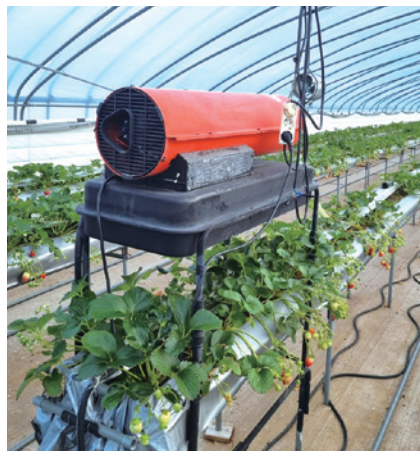
딸기 온실 온풍기(칠레이리응애 방사시에는 온풍기 사용을 조절해서 상대 습도를 '최소' 40% 이상(권장 50% 이상) 높게 유지해야 함)
